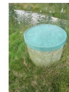
Utvendig tett tank for avløp.
