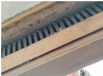
Kontroll av musesperre.
