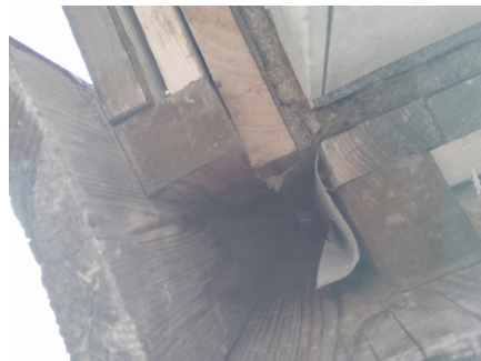
Manglende musesperre i hjørner.
