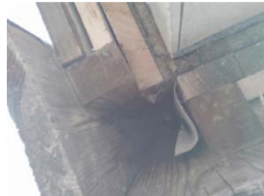
Manglende musesperre i hjørner.
