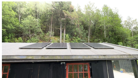
Solceller på tak.
