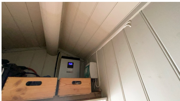
Del av solcelle anlegg.
