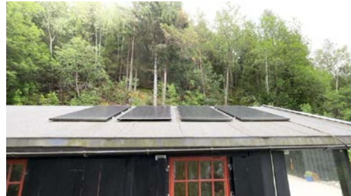
Solceller på tak.
