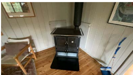
Montert ovn i stue.
