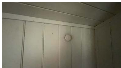
Eksempel på montert ventil i vegg.
