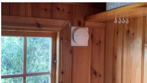
Eksempel på montert ventil i vegg.
