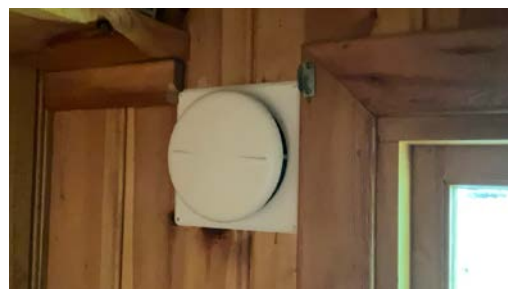
Eksempel på montert ventil i vegg.
