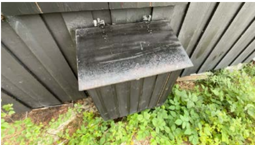
Utvendig skap til gass flasker.
