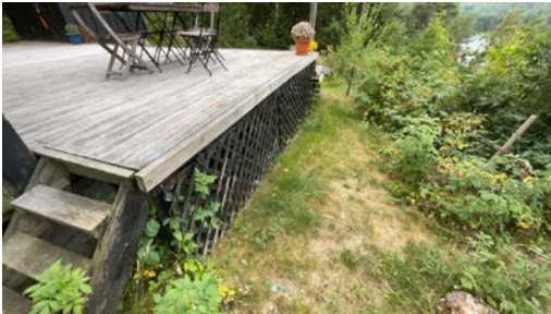
Del av terrasse. Det er ikke montert rekkverk.
