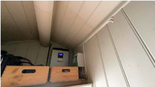
Del av solcelle anlegg.
