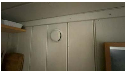
Eksempel på montert ventil i vegg.
