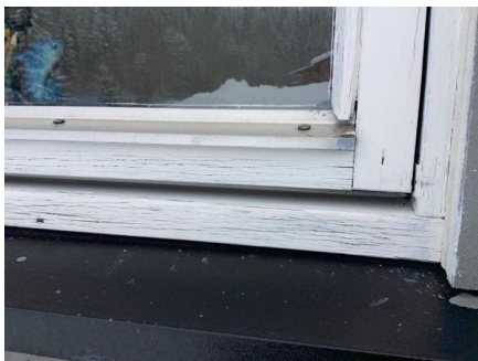
Eksempel på slitasje på vindu med isolerglass.
