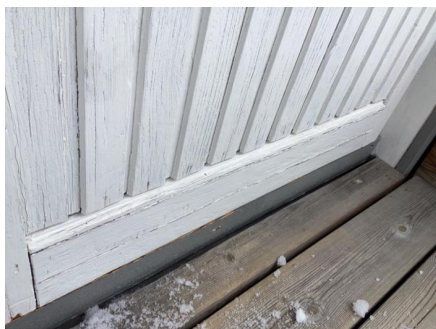
Utvendig slitasje på verandadør.
