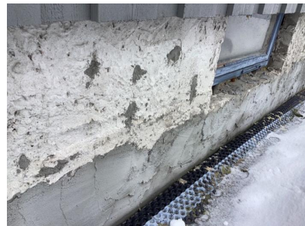
Grov utførelse av murpuss på grunnmur.
