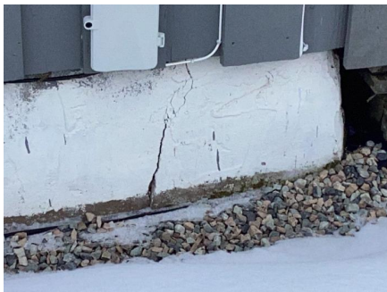
Eksempel på sprekk i grunnmur.
