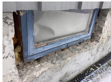
Eksempel på tilstand på kjellervindu.
