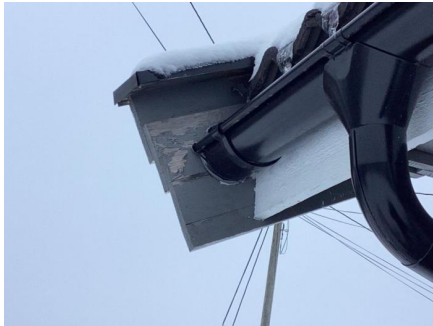
Eksempel på slitasje på vindski.
