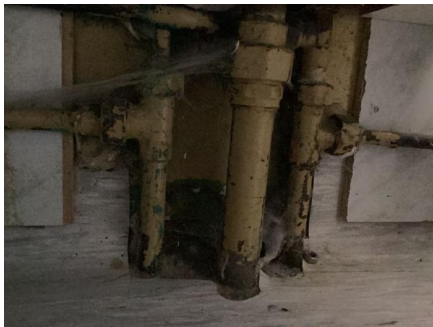
Utette gjennomføringer i gulv.
