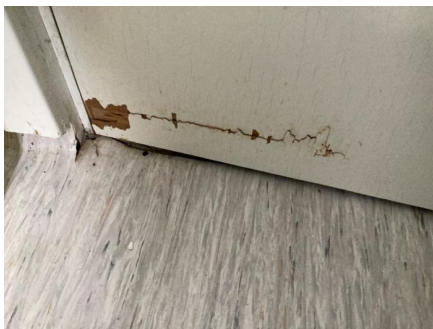
Skade på dør til bad.
