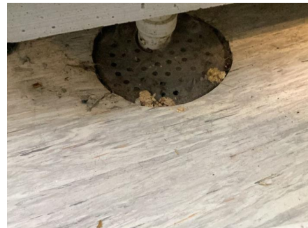
Utett overgang mellom sluk og gulvbelegg.
