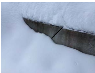
Eksempel på sprekk i støttemur ved inngang til kjeller.
