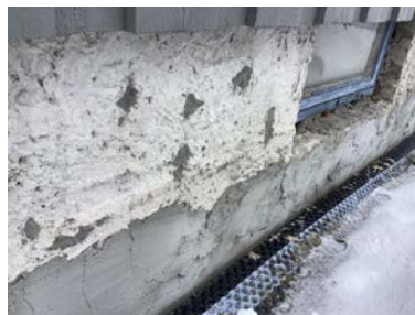
Grov utførelse av murpuss på grunnmur.
