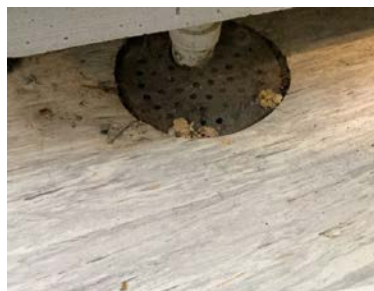
Utett overgang mellom sluk og gulvbelegg.
