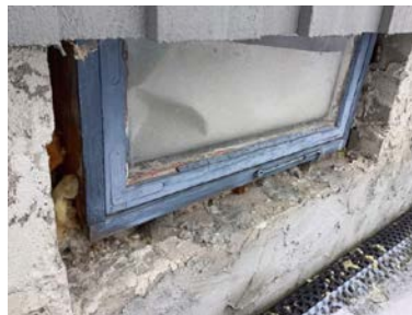
Eksempel på tilstand på kjellervindu.
