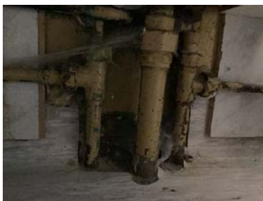
Utette gjennomføringer i gulv.
