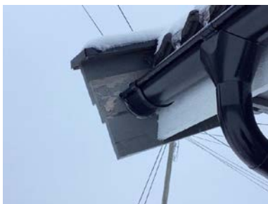
Eksempel på slitasje på vindski.
