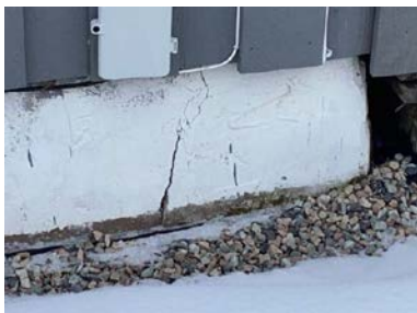
Eksempel på sprekke i grunnmur.
