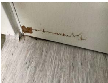
Skade på dør til bad.
