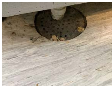
Utett overgang mellom sluk og gulvbelegg.
