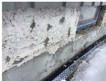
Grov utførelse av murpuss på grunnmur.
