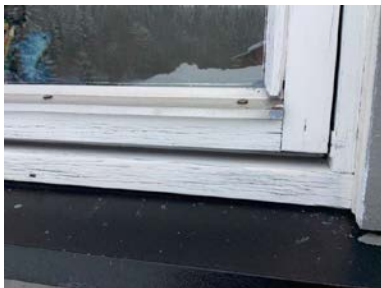
Eksempel på slitasje på vindu med isolerglass.
