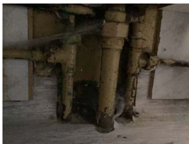
Utette gjennomføringer i gulv.
