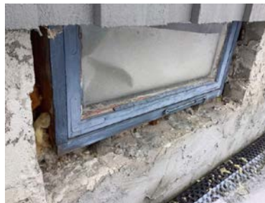
Eksempel på tilstand på kjellervindu.
