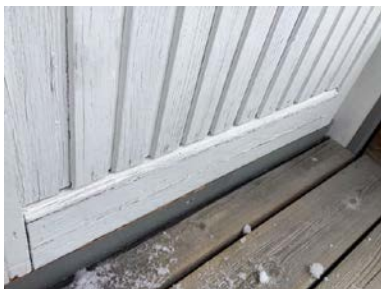
Utvendig slitasje på verandadør.
