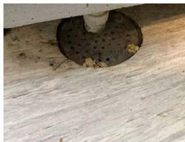
Utett overgang mellom sluk og gulvbelegg.
