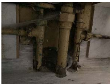
Utette gjennomføringer i gulv.
