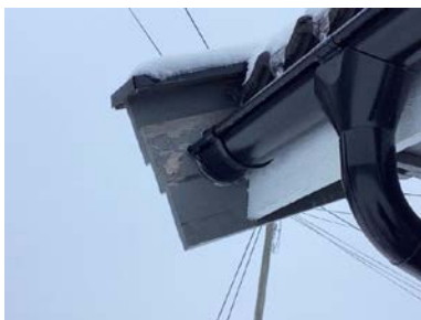
Eksempel på slitasje på vindski.
