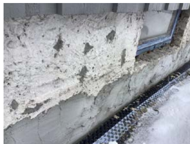
Grov utførelse av murpuss på grunnmur.
