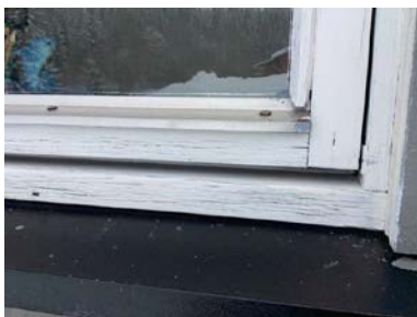
Eksempel på slitasje på vindu med isolerglass.
