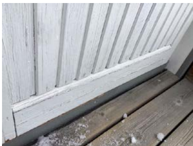
Utvendig slitasje på verandadør.
