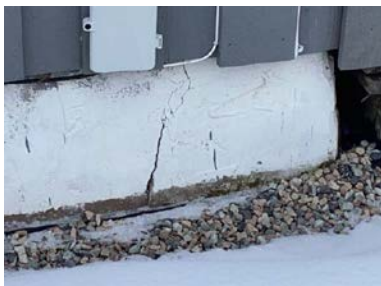
Eksempel på sprekke i grunnmur.
