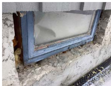
Eksempel på tilstand på kjellervindu.
