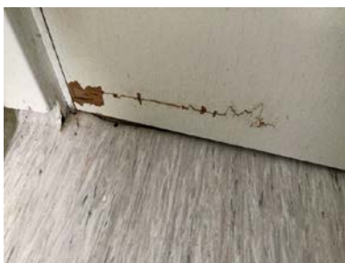
Skade på dør til bad.
