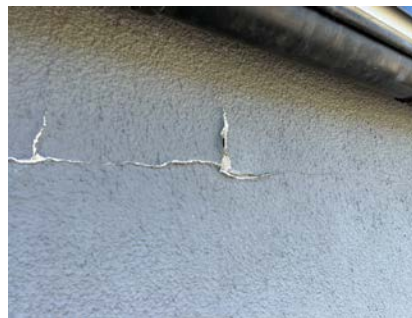
Riss i puss, saltutslag på vegg.
