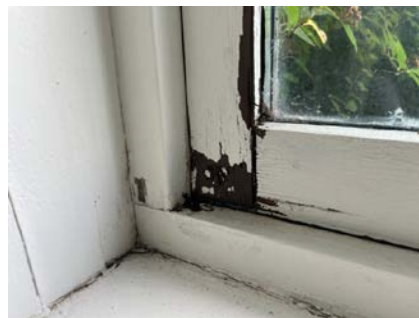
Råteskadet vindu i hybel
