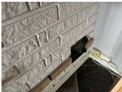
Liten avstand fra feieluke til trevegg.
