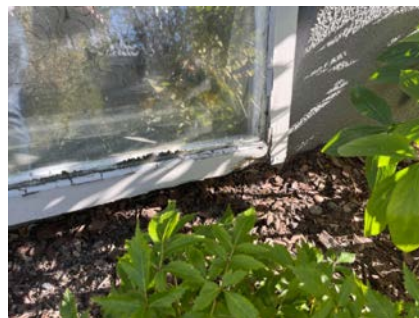
Råteskade i vindu
