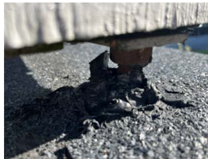
Dårlig tetting rundt stolpesko.
