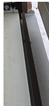
Løse utvendig aluminium på vindu utvendig
