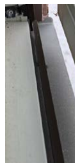
Løse utvendig aluminium på vindu utvendig
