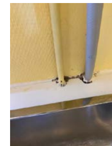
Noe svertesopp rundt rørgjennomføring.
