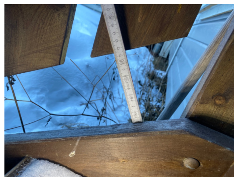
Åpninger i rekkverk ca. 11,5 cm.
