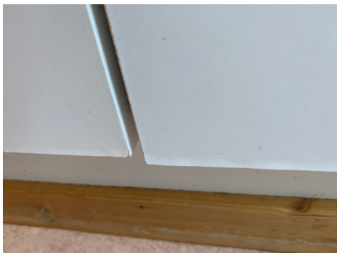
Svellinger i nedkant av dør
