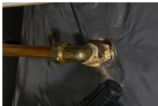
Eiringer mot tilkobling tank.
