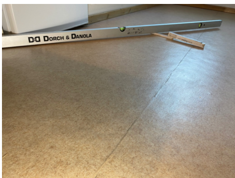
Lokale skjevheter mot kjøkken.
