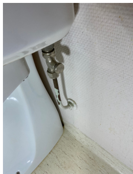
Boligen har innvendige vannrør av kobber.
