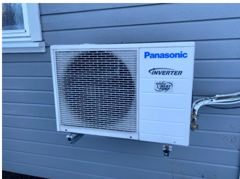
Varmepumpe utvendig del.
