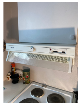
Kjøkkenventilatoren virker ikke.
