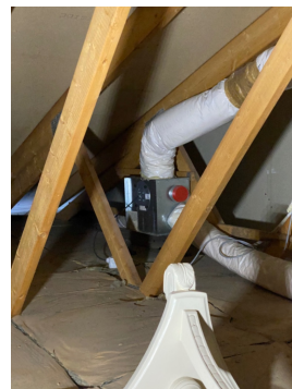
Avtrekk via aggregat på kaldloft.
