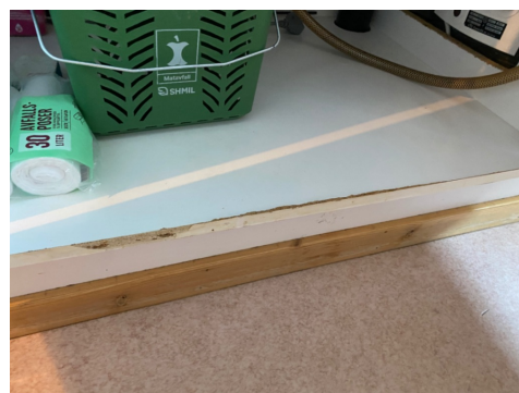
Slitasje, enkelte svellinger i skrog under vask.
