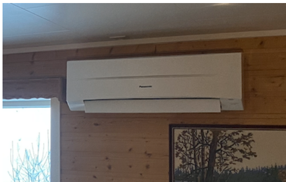
Varmepumpe innvendig del.
