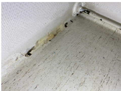
Fuging, tegn til utettheter i vinylbelegget i dusjonen.
