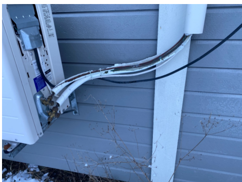
Isolasjon mot rør mangler.
