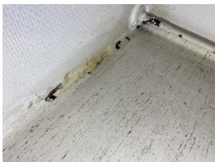
Fuging, tegn til utettheter i vinylbelegget i dusjsjonen.
