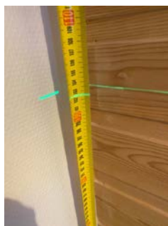
Måling av planavvik gjennom hele rommet.
