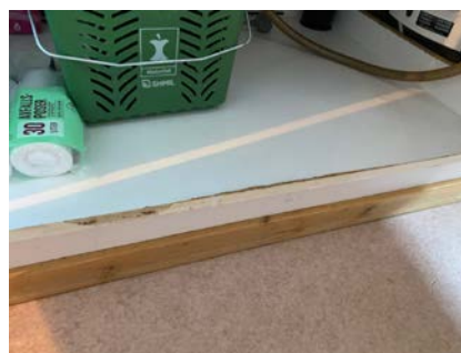
Slitasje, enkelte svellinger i skrog under vask.
