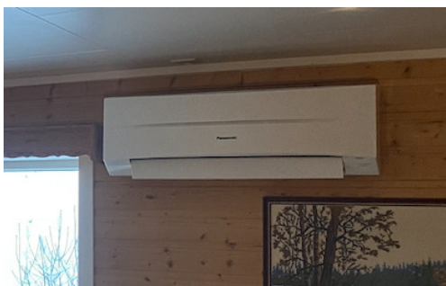
Varmepumpe innvendig del.
