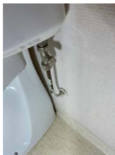
Boligen har innvendige vannrør av kobber.
