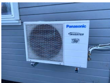
Varmepumpe utvendig del.
