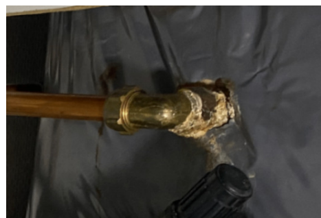
Eiringer mot tilkobling tank.
