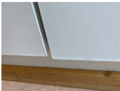
Svellinger i nedkant av dør
