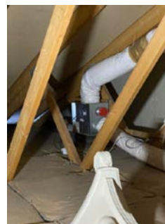
Avtrekk via aggregat på kaldloft.
