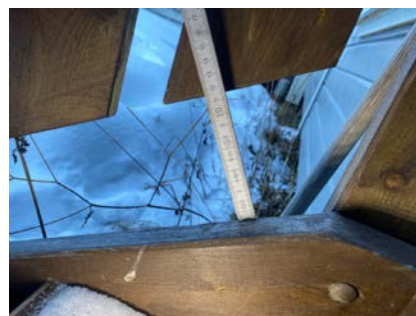
Åpninger i rekkverk ca. 11,5 cm.
