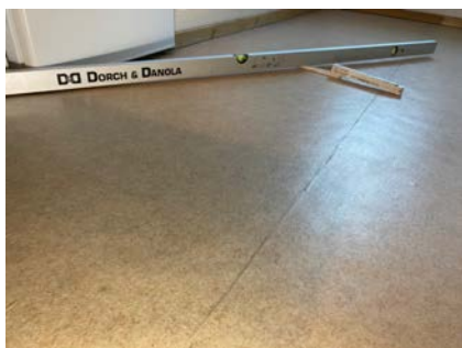
Lokale skjevheter mot kjøkken.
