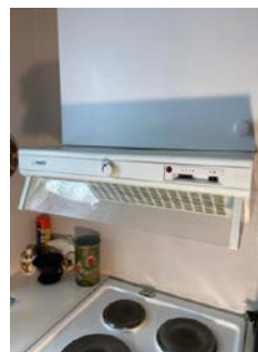
Kjøkkenventilatoren virker ikke.
