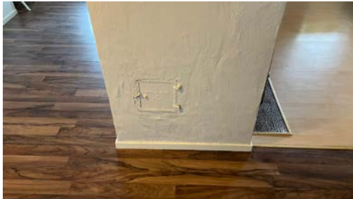
Sotluke uten ubrennbart materiale under.
