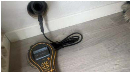
Fuktmåling i veggen inn mot badet
