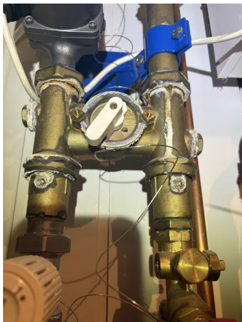
Korrosjon på rør til vannbåren varme.
