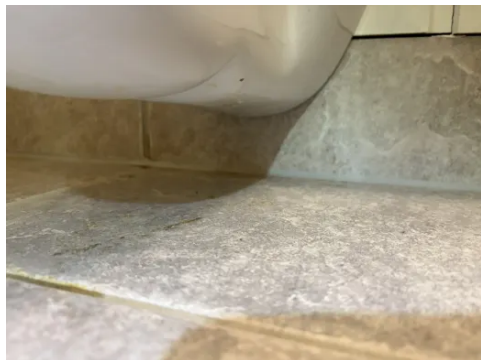
Manglende drenshull til innebygget wc.
