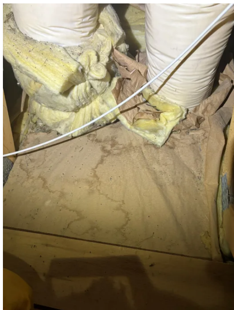
Fuktmerker i isolasjon ved gjennomføring i tak.
