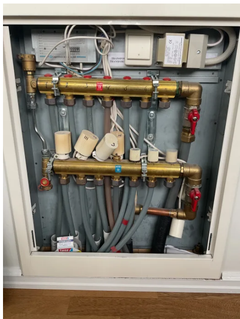
Fordelerskap til vannbårenvarme.
