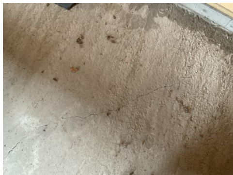
Sprekk i betongdekke.
