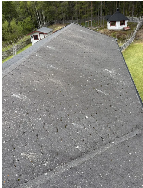
Mose på taktekking.
