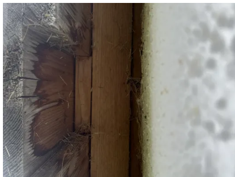
Fuktmerker på baksiden av kledning.
