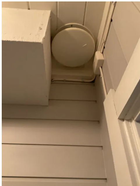
Naturlig avtrekk i himling
