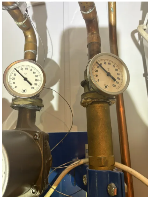
Korrosjon på rør til vannbåren varme.
