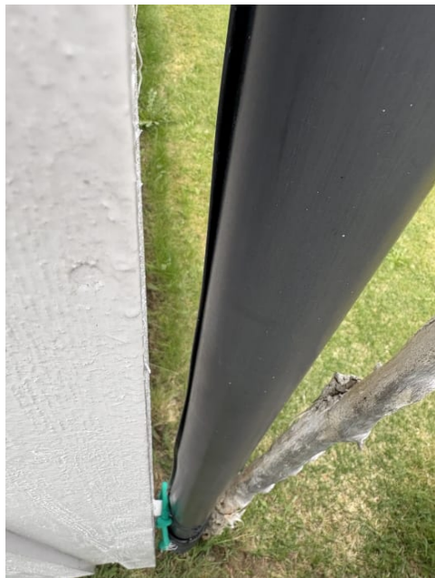
Frostsprenng i nedløp.
