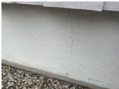
Sprekk i grunnmur.
