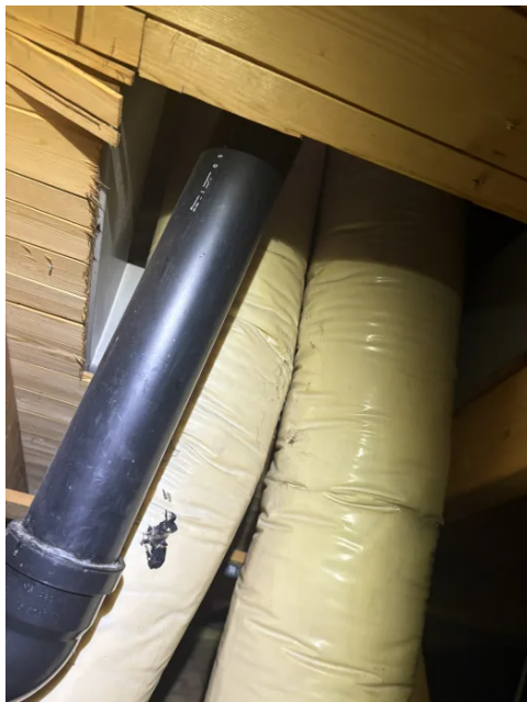
Manglende isolering av lufting.
