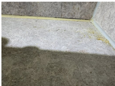
Sprekker i overgang gulv vegg.
