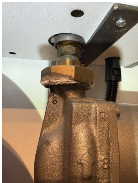
Korrosjon på rør til vannbåren varme.
