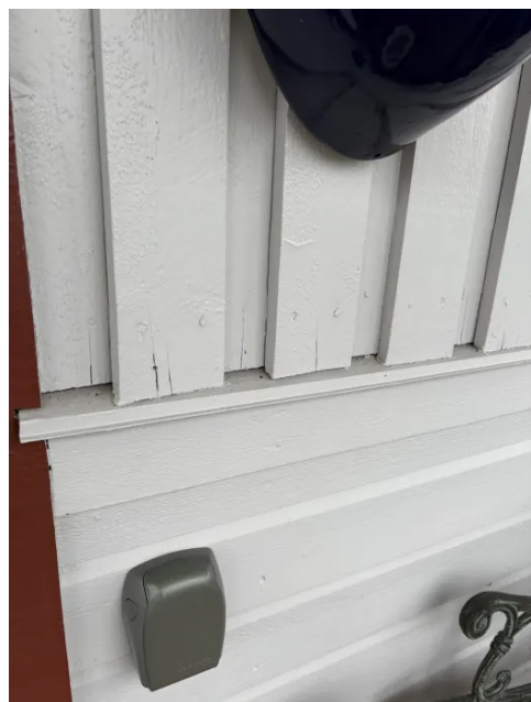
Sprekker i pamel.
