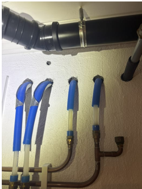
Manglende tettesjikt rundt rørgjennomføringer.
