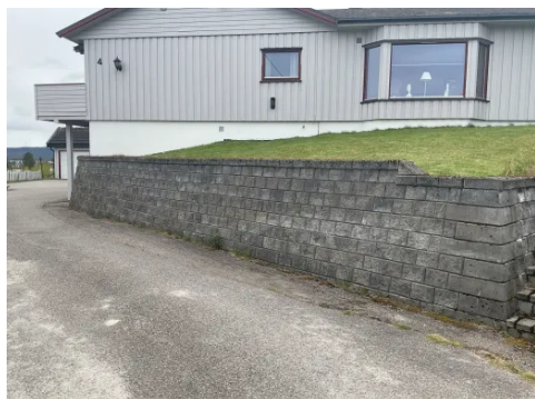
Manglende rekkverk på støttemur.
