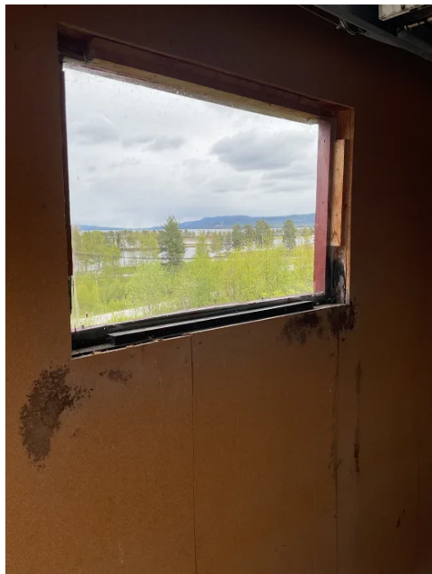
Fuktskader rundt vindu.
