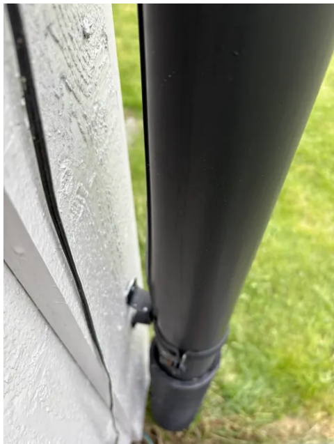
Frostspreg i nedløp.
