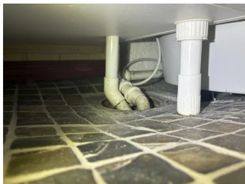
Sluk under innredning.
