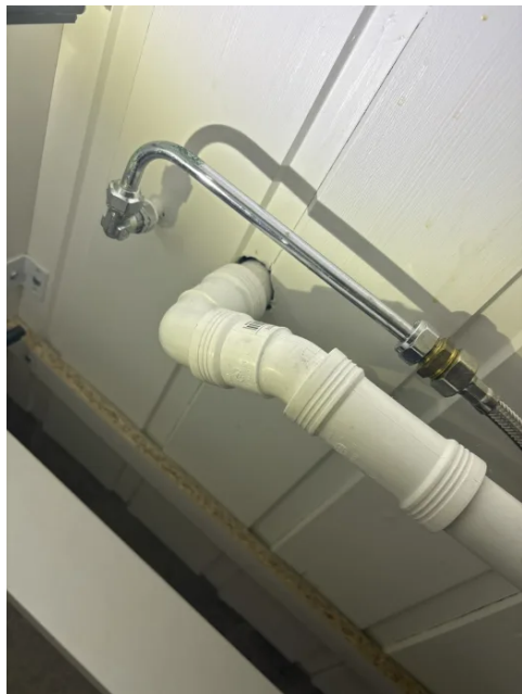
Manglende tetting på rørgjennomføringer.
