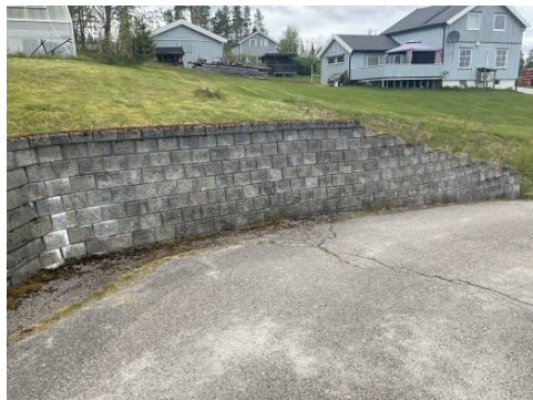
Manglende rekkverk på støttemur.
