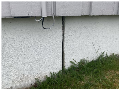
Sprekk mellom tilbygg og gammel del.
