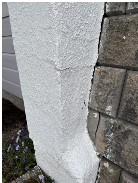
Sprekk i murpuss.
