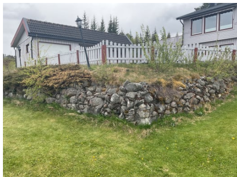
Manglende rekkverk på støttemur.
