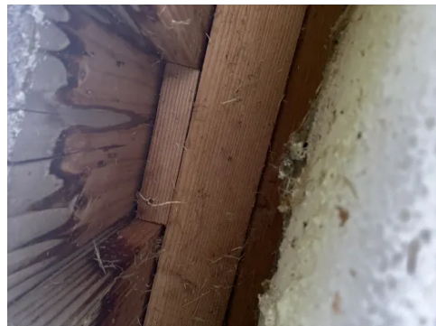
Manglende lufting av kledning.
