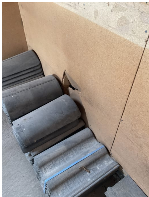
Skade i vegg.
