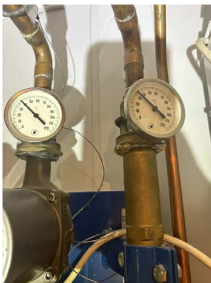
Korrosjon på rør til vannbåren varme.
