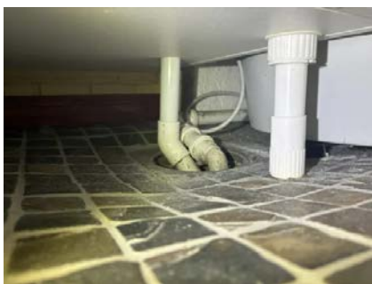
Sluk under innredning.
