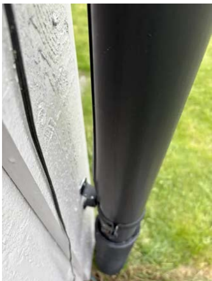
Frostspreg i nedløp.
