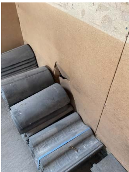
Skade i vegg.
