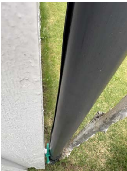
Frostsprengh i nedløp.
