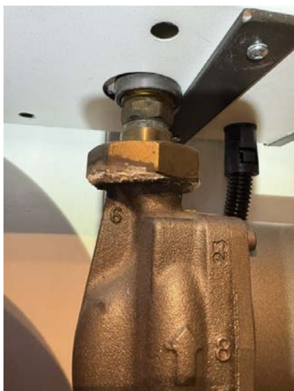
Korrosjon på rør til vannbåren varme.
