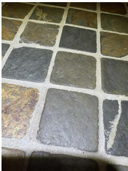
Sprekk i slisfuger.
