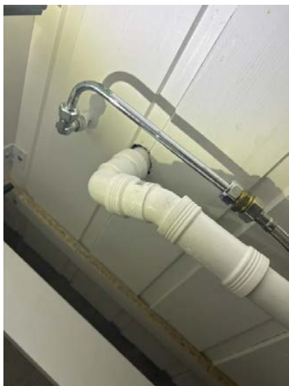
Manglende tetting på rørgjennomføringer.
