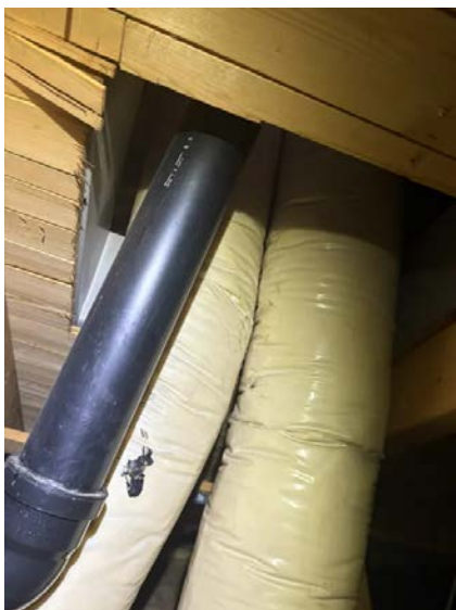
Manglende isolering av lufthing.
