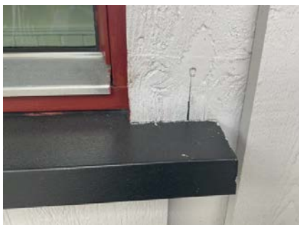
Panel ned til vannbrett.
