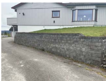
Manglende rekkverk på støttemur.
