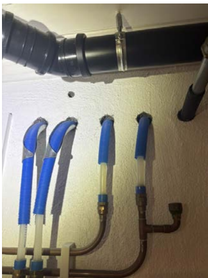
Manglende tettesjikt rundt rørgjennomføringer.
