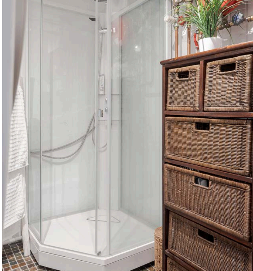
Det er også montert et dusjkabinett på vaskerommet.
