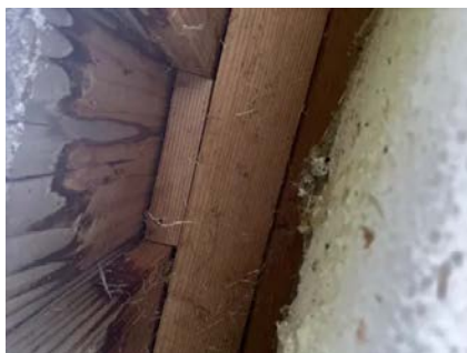
Manglende lufting av kledning.
