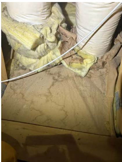
Fuktmerker i isolasjon ved gjennomføring i tak.
