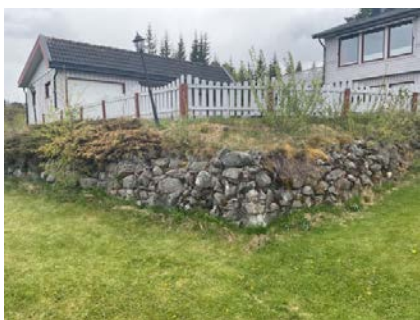
Manglende rekkverk på støttemur.
