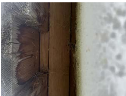
Fuktmerker på baksiden av kledning.
