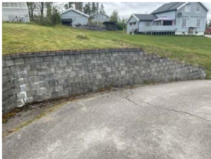
Manglende rekkverk på støttemur.
