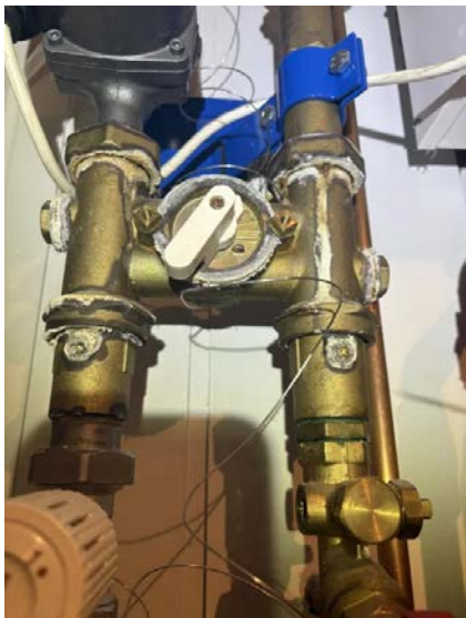
Korrosjon på rør til vannbåren varme.
