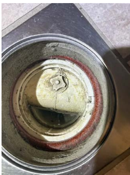
Sluk i del av bad eldre del.
