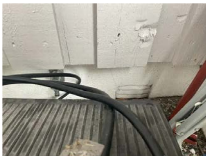
Sprekk i grunnmur.
