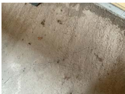
Sprekk i betongdekke.
