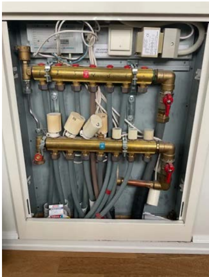
Fordelerskap til vannbårenvarme.
