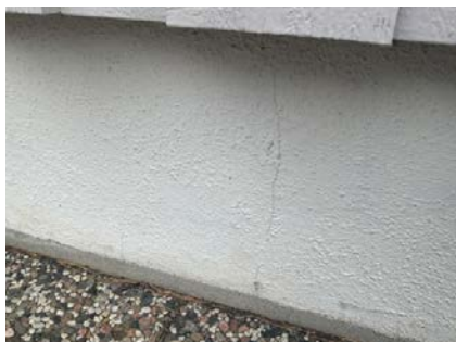
Spekk i grunnmur.
