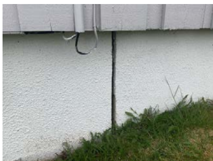
Sprekk mellom tilbygg og gammel del.
