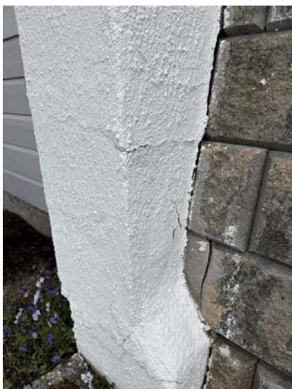
Sprekk i murpuss.
