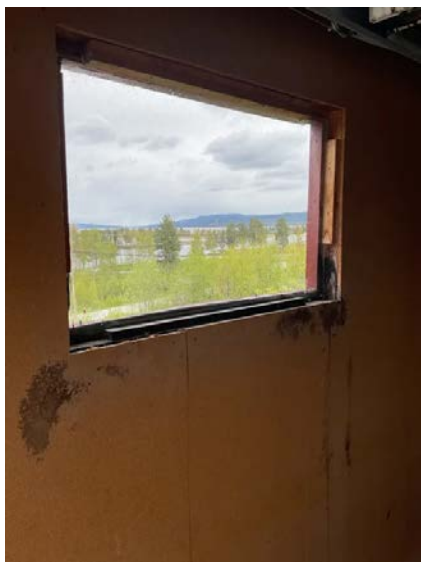
Fuktskader rundt vindu.
