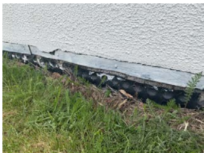
Svikt i tetting mellom list og grunnmursplast.
