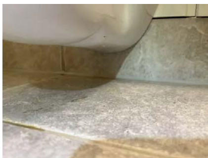
Manglende drenshull til innebygget wc.
