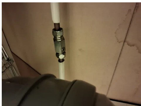
Stoppekran mangler hendel.
