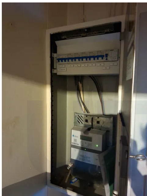
Sikringsskap med automatsikringer er plassert i entré.
