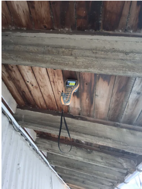
Fuktmåling i undertak på 19,0 vektprosent.
