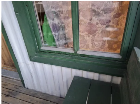
Kjøkkenvindu er værslitt.
