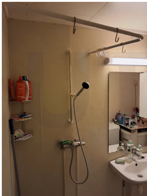
Svelleskader på veggplater i dusjsone.
