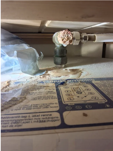
Det registreres korrosjon og drypplekkasje på varmtvannsberederen.
