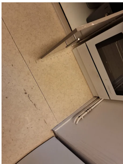
Det registreres en sprekke i gulvbelegg og slitasje på innredning.
