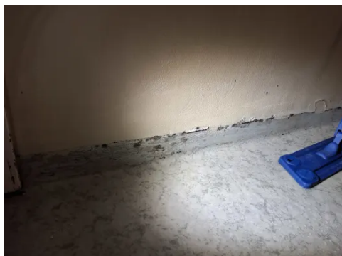
Svertesopp på gulvbelegg.
