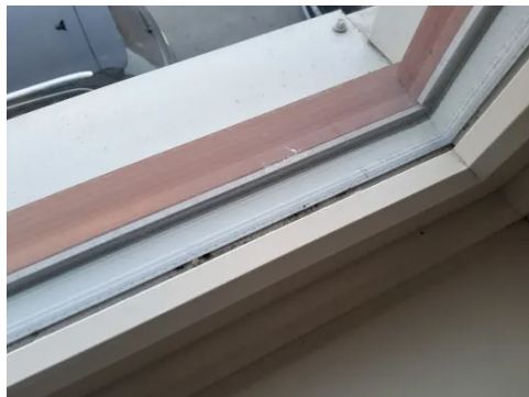
Tegn til svertesopp registreres på pakninger i enkelte vinduer.
