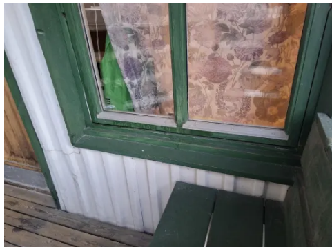
Kjøkkenvindu er værslitt.
