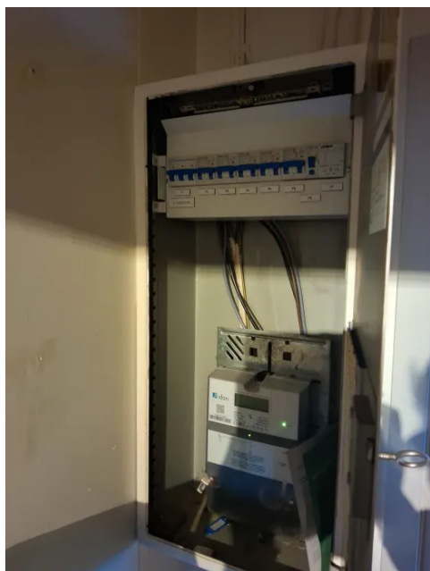
Sikringsskap med automatsikringer er plassert i entré.
