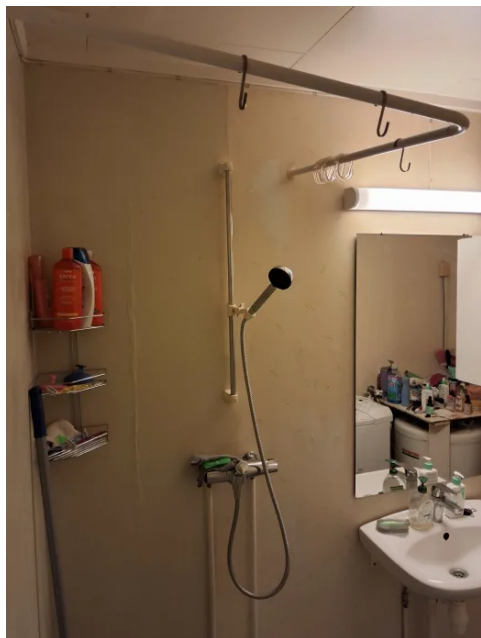
Svelleskader på veggplater i dusjsone.
