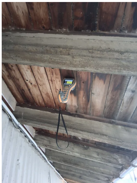
Fuktmåling i undertak på 19,0 vektprosent.
