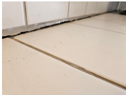
Glippe mellom vegg og gulv.
