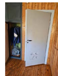
Eksempel på dørblad med skade.
