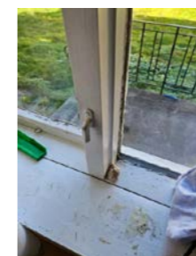
Eksempel på vindu med råteskade.
