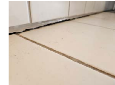
Glippe mellom vegg og gulv.
