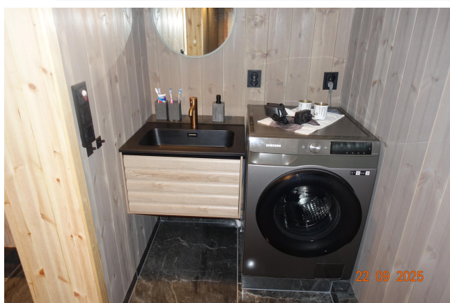
Vask montert i vaskerommet
