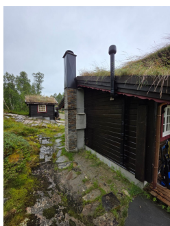
Pipe og beslag for badstue, mangler feieplattform
