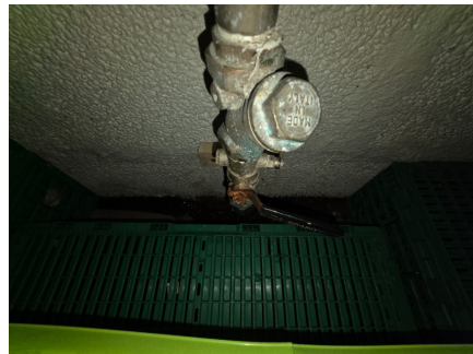
Stoppekran plassert i kjeller på uthus
