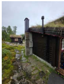
Pipe og beslag for badstue, mangler feieplattform
