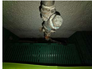
Stoppekran plassert i kjeller på uthus
