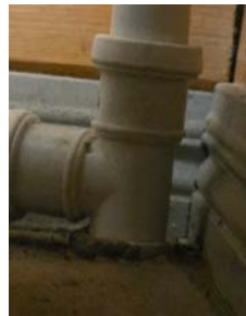
-Rørføring gjennom gulv har ikke "mansjett" oppkant/tettesjikt på 25mm
