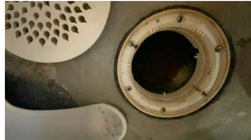
Ingen synlig bruk av membran "mansjett" i sluk
