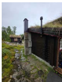
Pipe og beslag for badstue, mangler feieplattform
