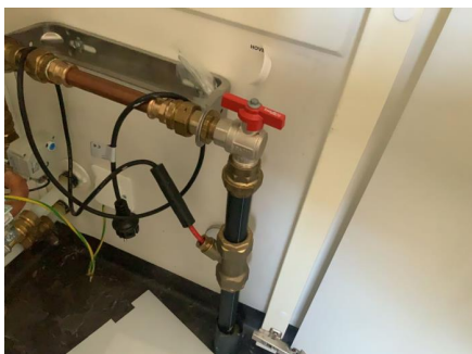
Stoppekran plassert på teknisk rom.
