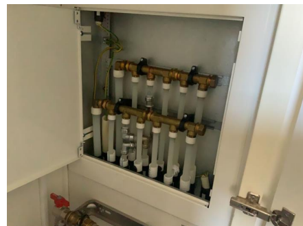
Fordelingsskap plassert på teknisk rom.
