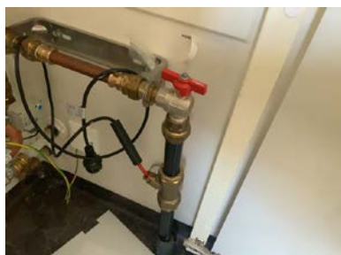
Stoppekran plassert på teknisk rom.
