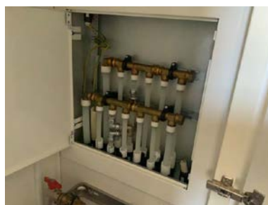
Fordelingskap plassert på teknisk rom.
