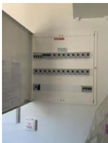
Sikringsskap plassert på teknisk rom.
