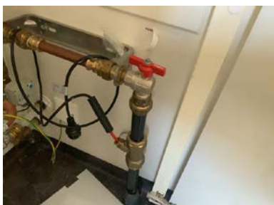
Stoppekran plassert på teknisk rom.
