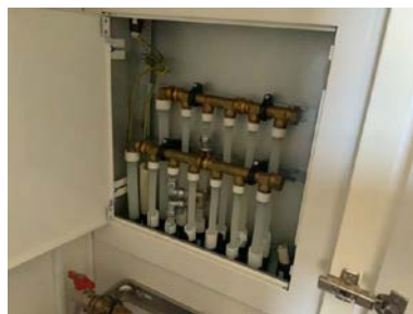
Fordelingskap plassert på teknisk rom.
