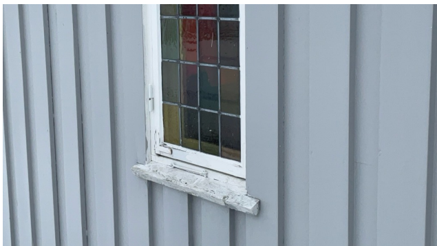
Manglende beslag på vannbrett.
