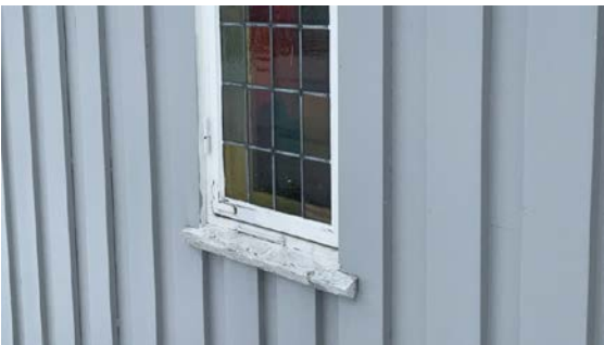
Manglende beslag på vannbrett.
