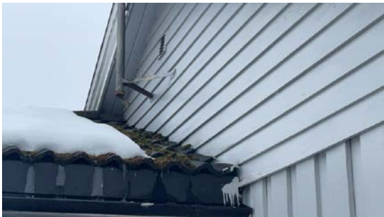
Manglende vannbrett og beslag.
