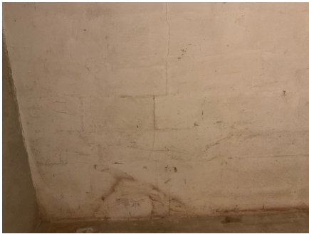
Sprekk synlig innvendig i bodrom
