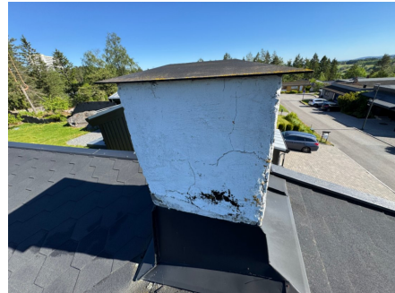
Pipen over tak med synlige sprekker og løs puss stedvis
