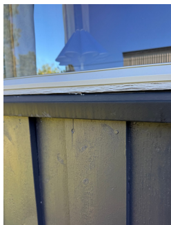
Eksempel på vedlikeholdsbehov utvendig.
