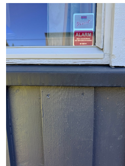
Eksempel på vedlikeholdsbehov utvendig.
