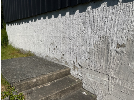
Avskalling puss og maling
