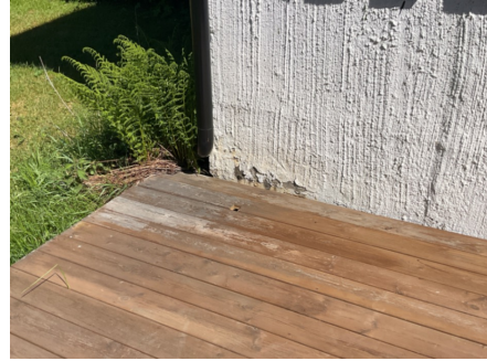
Avskalling puss og maling
