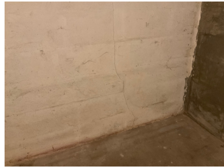
Sprekk synlig innvendig i bodrom
