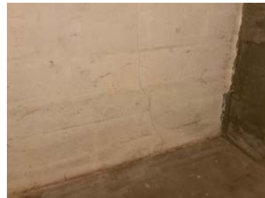
Sprekk synlig innvendig i bodrom
