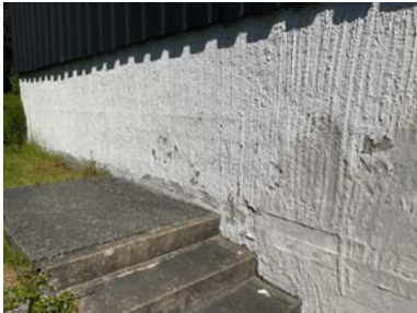
Avskalling puss og maling
