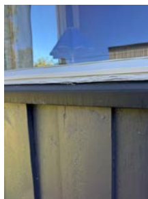
Eksempel på vedlikeholdsbehov utvendig.
