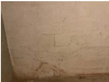
Sprekk synlig innvendig i bodrom
