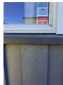
Eksempel på vedlikeholdsbehov utvendig.
