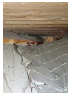
Fuktskade i kilrenne, overgang til tilbygd stue.
