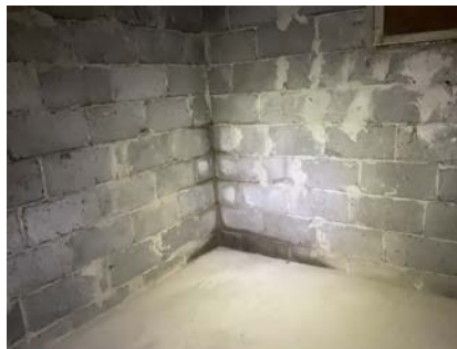
Fukt i nedre del av kjellervegg.
