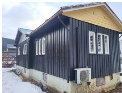
Malingsavflassing på gavlkledning og vindskibord.
