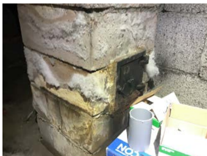
Sotluke i kjeller og saltutslag på pipe.
