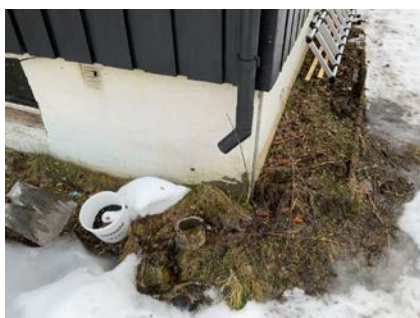
Avløpsrør er ikke tilkoblet overvannsrør.
