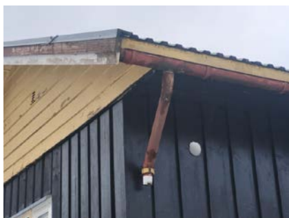
Takrenner og nedløpsrør fra byggeår. Nedløpsrør mangler på vegg.
