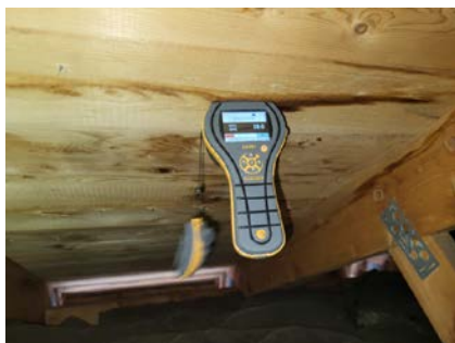
Fuktmåling i tre med forhøyede fuktverdier
