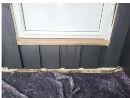
Det er ikke etablert beslag under terrassedøra.
