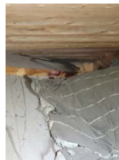
Fuktskade i kilrenne, overgang til tilbygd stue.
