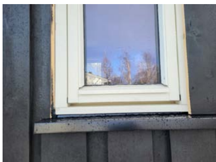
Hjørnet er fuget tett, manglende karmbord.
