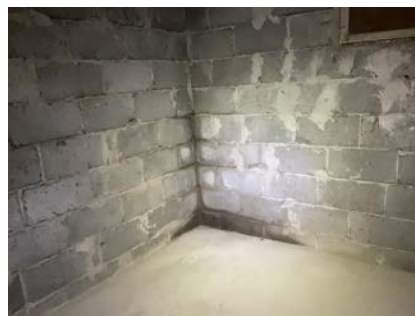
Fukt i nedre del av kjellervegg.
