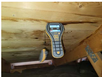
Fuktmåling i tre med forhøyede fuktverdier
