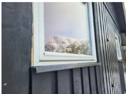
Skjevheter i underbeslag, feil vinkel på underbeslag og manglende karmbord på vindu
