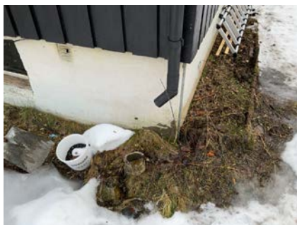
Avløpsrør er ikke tilkoblet overvannsrør.
