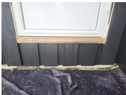
Det er ikke etablert beslag under terrassedøra.
