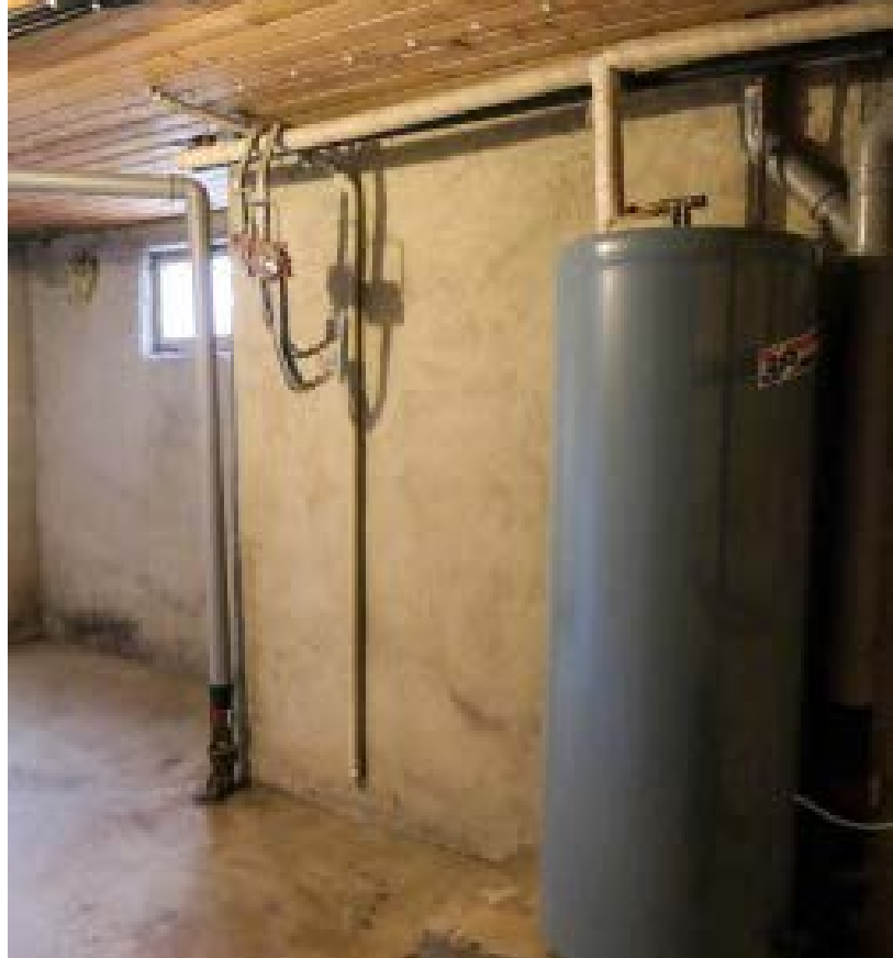
Kjeller med varmtvannstank
