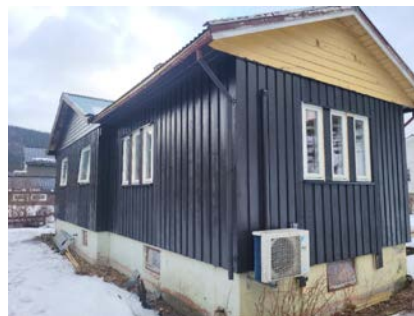
Malingsavflassing på gavlkledning og vindskibord.
