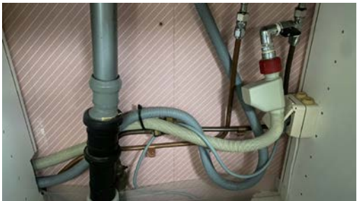
Røropplegg under kjøkkenbenk.
