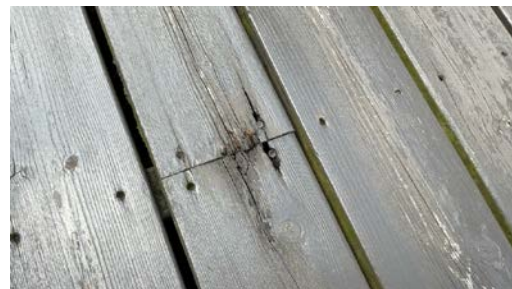
Råteskadde gulvbord må skiftes.
