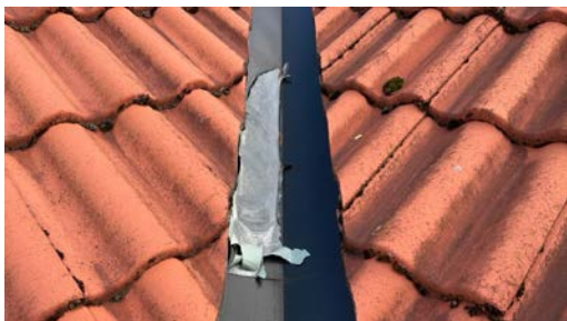
Beslag over inngangsdøra bør utbedres.
