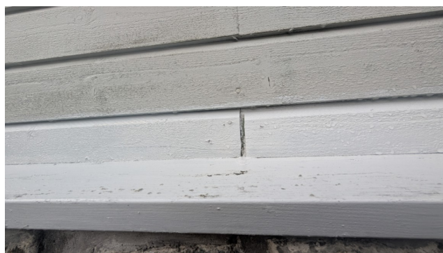
Enklere skjøt som er utett.
