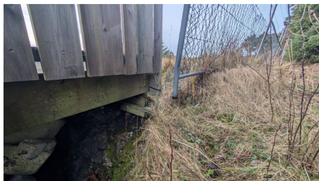
Eksempel på usikker fundamentering.
