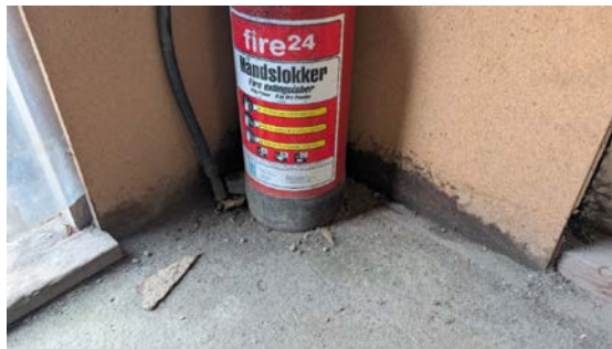
Synlig fuktighet innvendig vegg i garasje. ukjent hvor fukten kommer i fra.
