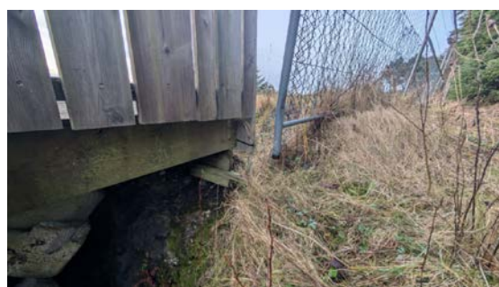
Eksempel på usikker fundamentering.
