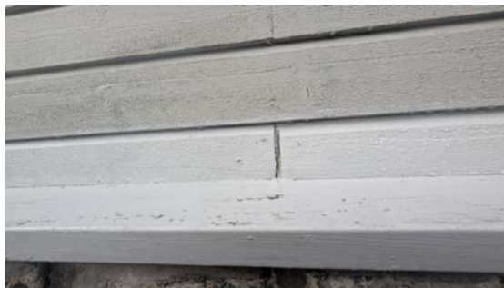
Enklere skjøt som er utett.
