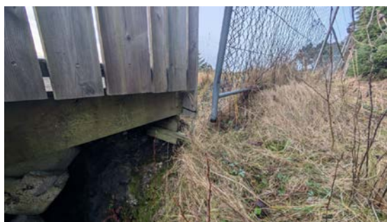
Eksempel på usikker fundamentering.
