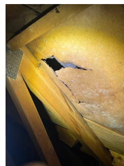
Ødelagt sutakplate ved innvendig gradrenne
