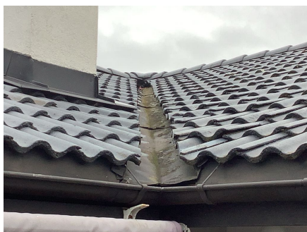
Værslitasje i gradrenne. Bør sees på.
