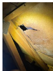
Ødelagt sutakplate ved innvendig gradrenne
