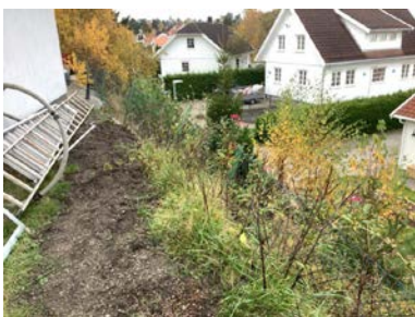
Gjerde må repareres.
