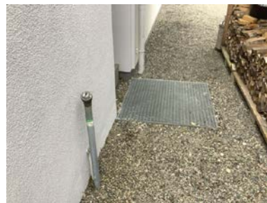
Påfyllingsrør mellom veranda og garasje.
