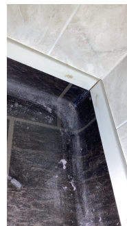
Ufagmessig utførelse av overgang belegg/baderomsplater.
