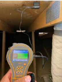
Ingen påvist fukt i plater på befaringstidspunktet.
