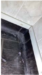
Ufagmessig utførelse av overgang belegg/baderomsplater.
