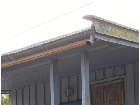
Kun utkast, ingen nedløp.
