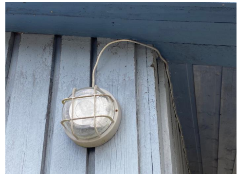
Løse/dårlig klamrede kabler
