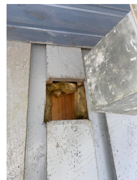
Løs luftkanal (tettet på insiden) med større åpninger rundt.
