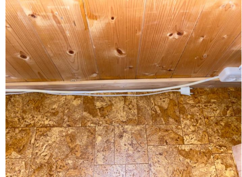
Løse/dårlig klamrede kabler til stikk.
