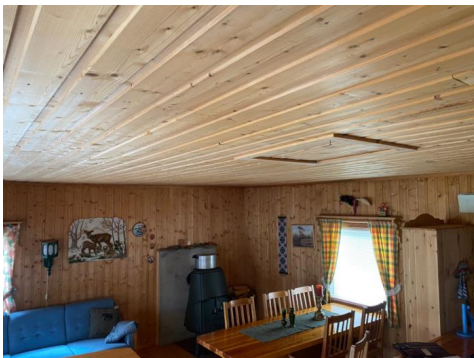
Nedbøyning av stuehimling.
