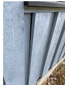
Dårlig tetting/overlapp av utvendig kledning.
