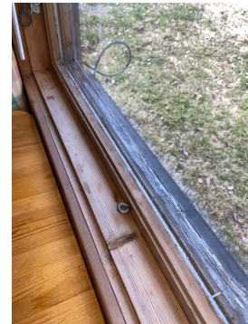
Oppsprukket og fuktskadet treverk mellom vindusglass pga kondensering.
