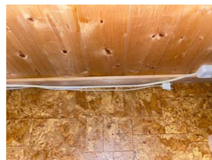
Løse/dårlig klamrede kabler til stikk.
