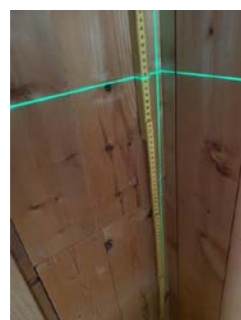
25 mm høydeforskjell fra vindu soverom til hjørne ved dør (innenfor 2 meter)
