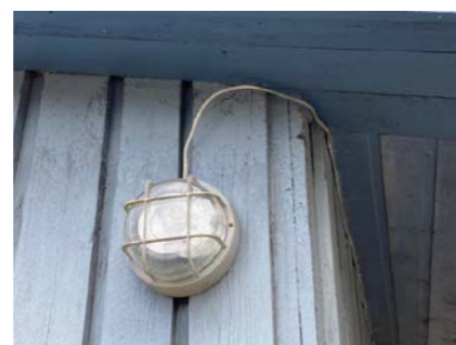
Løse/dårlig klamrede kabler
