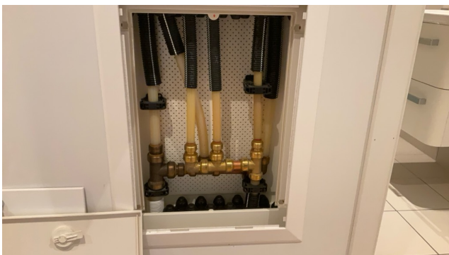
Rørskap i gangen.
