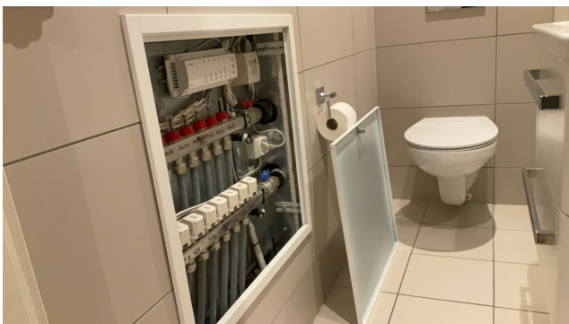
Rørskap på wc.
