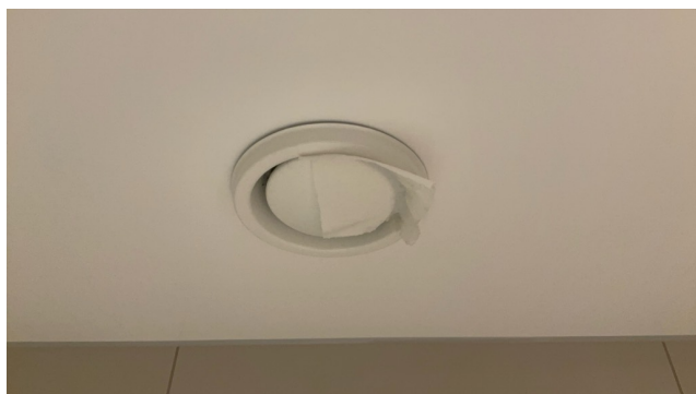
Test av avtrekk. Papiret henger.
