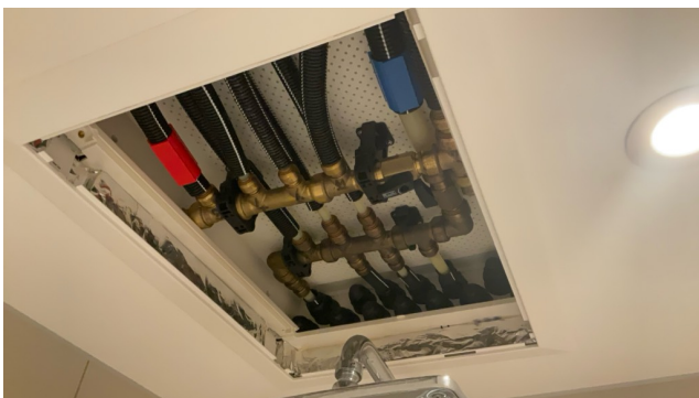
Rørskap på badet.
