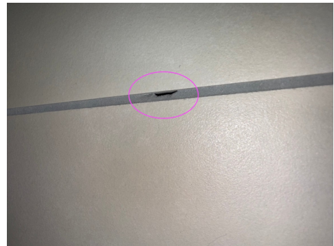
Fuge er ikke fylt med fugemasse.
