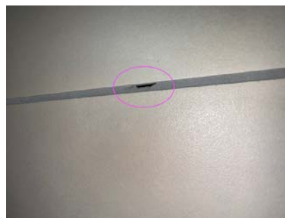
Fuge er ikke fylt med fugemasse.
