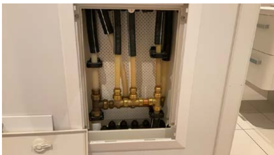
Rørskap i gangen.
