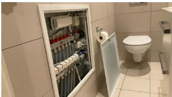
Rørskap på wc.
