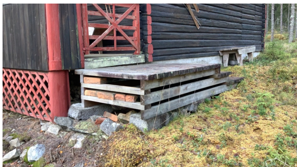
Trapp mangler rekkverk.
