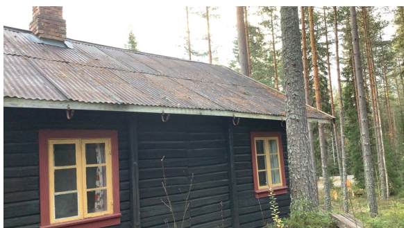
Skjevheter i takkonstruksjonen.
