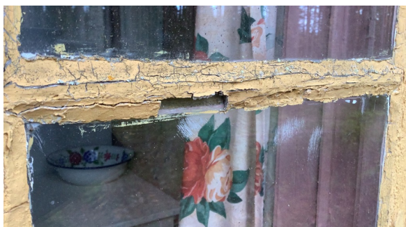
Eksempel på værslitt vindu.
