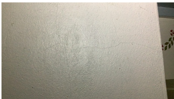
Eksempel på riss i puss på pipe.
