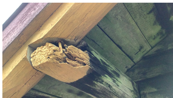
Råteskadet ende av toppsvill.
