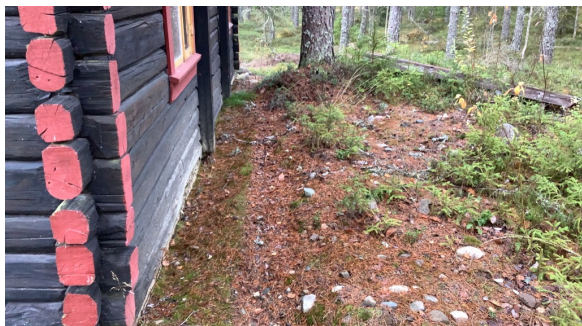
Utilfredsstillende fall fra bygning.
